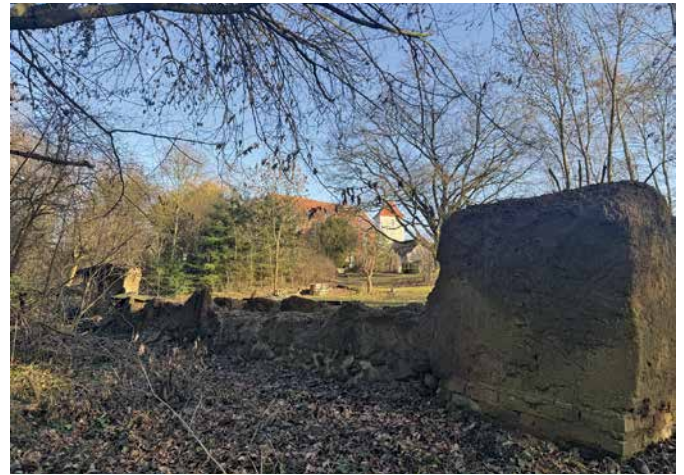
Zustand der Lehm-mauer in Weltewitz
