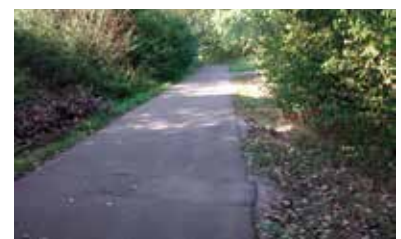
Das Asphaltband an den Langen Stücken wurde im Zuge der Straßeninstandhaltung mit ausgebessert.
