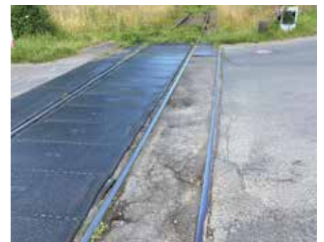
Im Moment reiht sich am Bahnübergang in der Bergstraße Loch an Loch.
