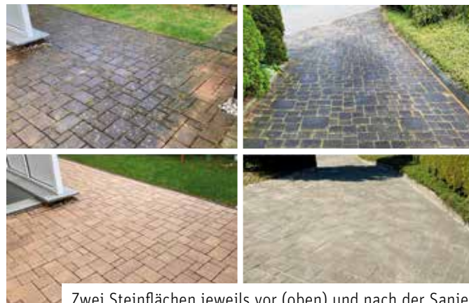
Zwei Steinflächen jeweils vor (oben) und nach der Sanierung (unten). (Fotos: MH Stone)
