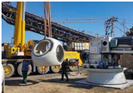
Windkraftanlage mit 750 kW Nennleistung.
