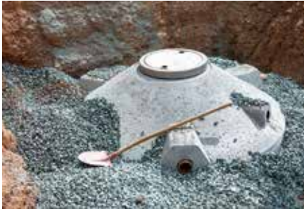
Zisterne zur Speicherung von Regenwasser
