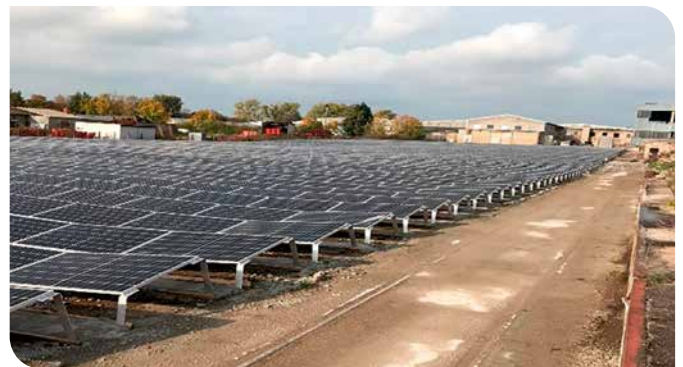
Beispiel einer bereits errichteten Anlage
