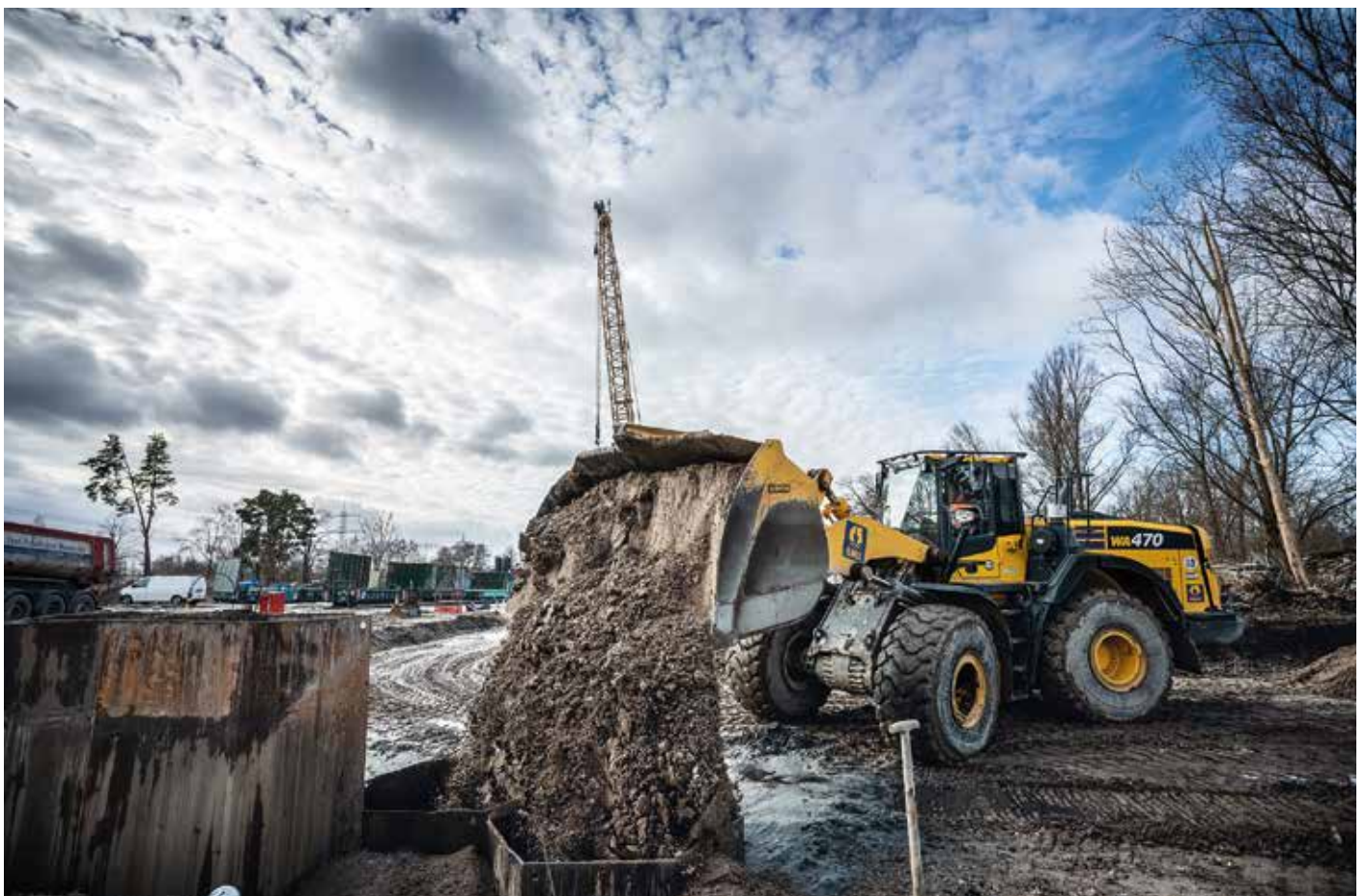
Insgesamt werden rund 2.200 m 3 belasteter Boden ausgetauscht und in speziellen Containern abtransportiert. (Alle Bilder: © BAUER Gruppe)
